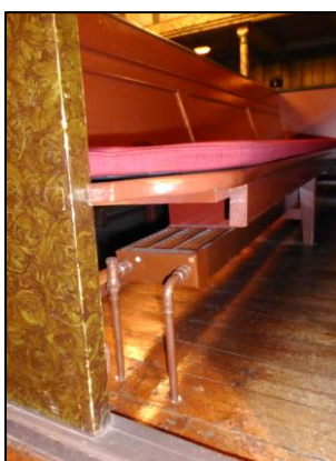
Radiator under kirkebenk
