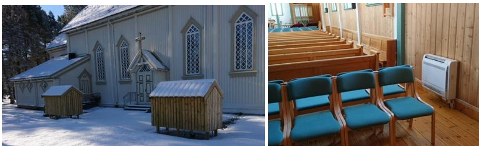
Luft/luft varmepumpeanlegg i Saltdal kirke
