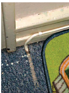
Ubeskyttet kabel fritt lagt under teppe
