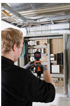
Termografering av utstyr i elektrisk tavle
