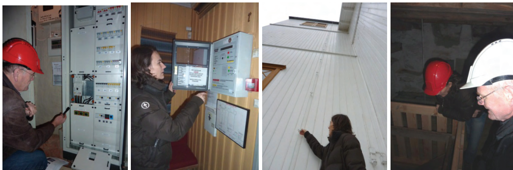
Inspeksjon og kontroll av viktig utstyr i el-tavle
