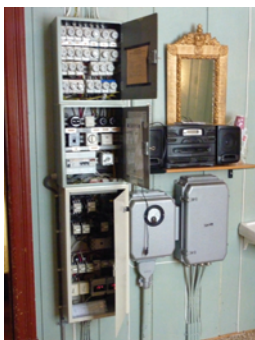
Mange el.tavler med både eldre/nyere utstyr
