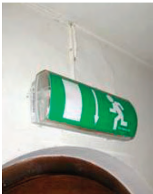
Nødlysskilt over dør til utgang via sakristi
