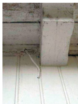
Eldre kabel med ikke akseptabel avslutning
