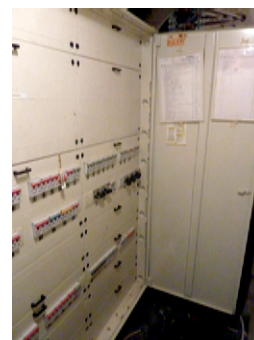
Ny lukket el-tavle med all nødvendig sikringsutstyr
