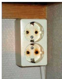
Tegn til dårlig kontakt/ varmgang i stikkontakt
