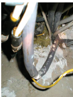
Mangelfull brannetting i gjennomføring i el-skap
