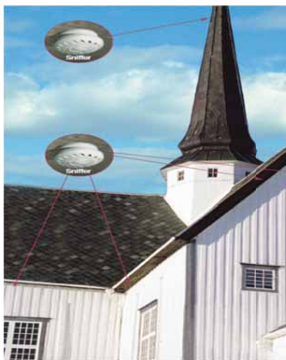
Aspirasjonsanlegg hvor små sensorer under gesims fanger opp om det er brannrøyk i nærheten.
