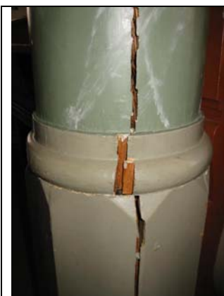
Sprekk søyle under galleri
