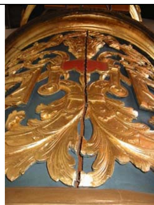
Sprekk i prekestol
