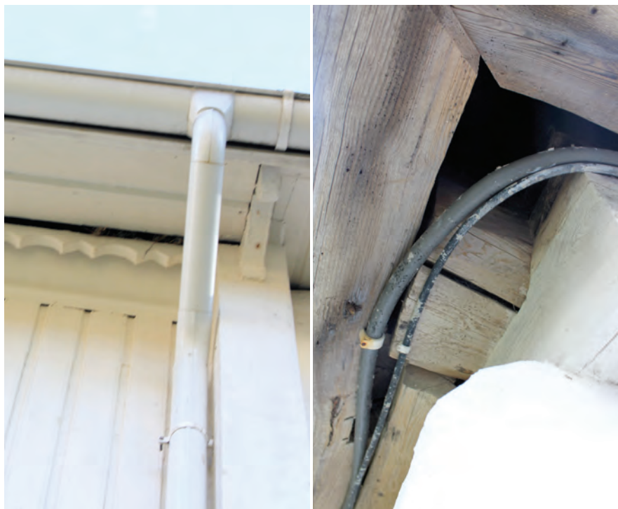
Figur 21. Mange eldre kirkebygg har unødvendige glipper og åpninger i den ytre fasaden. Dette er åpninger hvor en brann vil spre seg raskt til loft og takkonstruksjonen.
