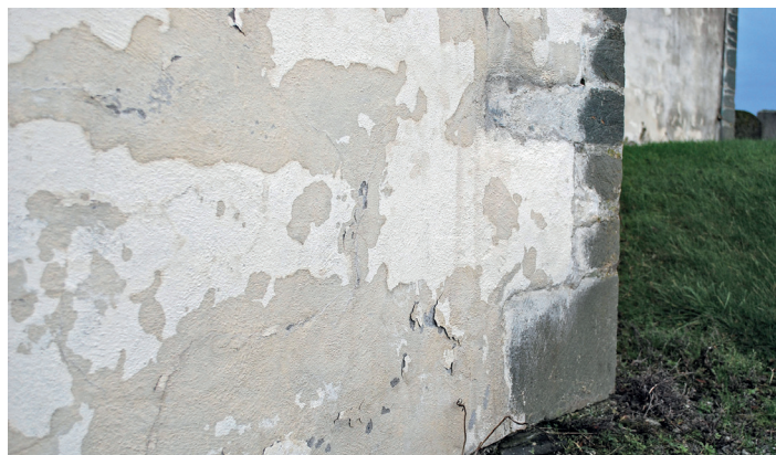
▲ Sørbo kirke har i dag store skader på sørfasaden. Hvorfor er det slik? Riksantikvarens arkiv gir ledetråder.
