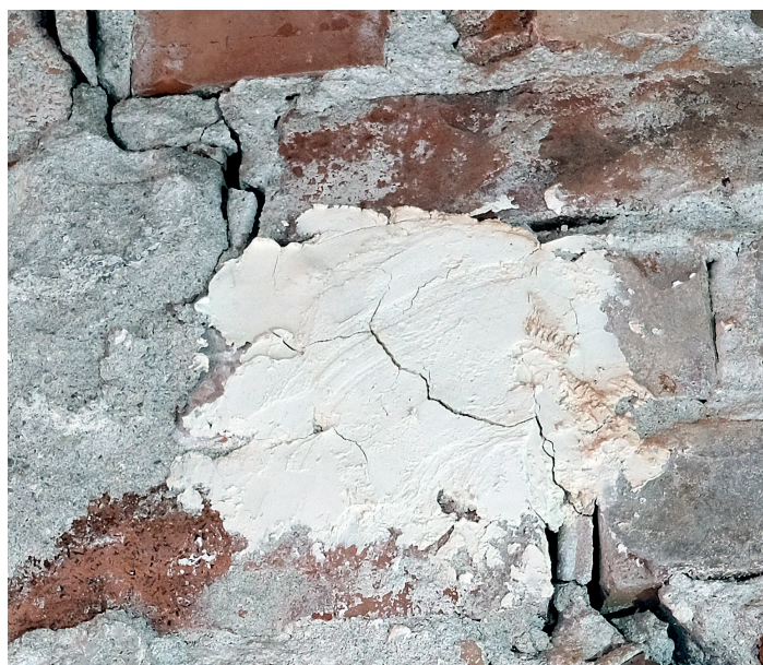
▲ Gipsplomber er en enkel og sikker metode for sprekkeovervåkning. Men er plomben sprukket, får man ikke informasjon om videre utvikling. Da må man sette på en ny. Foto: Vegard Røhme, Fabrica
