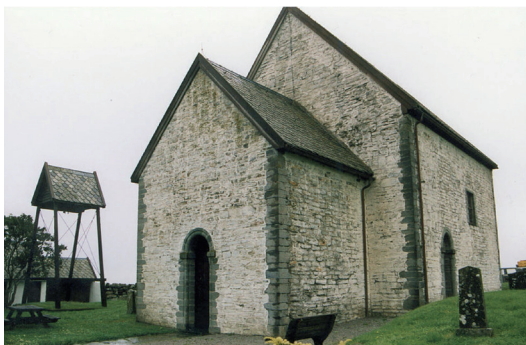
▲ 2000: Sementslemmingen er altfor tett og har etter 30 år fått store skader. Foto: Nyquist, RAs arkiv
