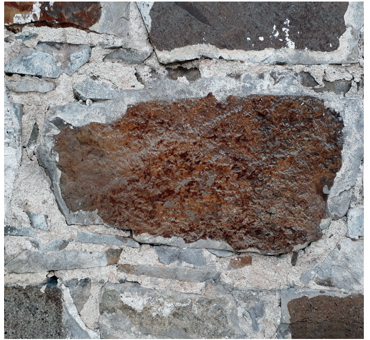
▲ Murene i mange kirker er preget av bruk av lokal stein, kalkmørtel og mye piningstein i fugene. Tingelstad gamle kirke, etter meisling av tynn sementpuss over fugene.
