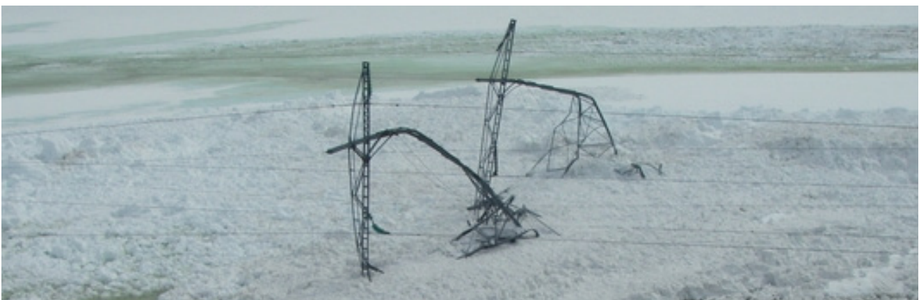
Foto under: Statsnett sine master i Melhusdalen i Bardu, Troms ble knekt av sørpeskred 17. mai 2010. Temperaturen steg fra minusgrader til over 20 plussgrader i løpet av en dag. (E. Eidissen, Statnett)
