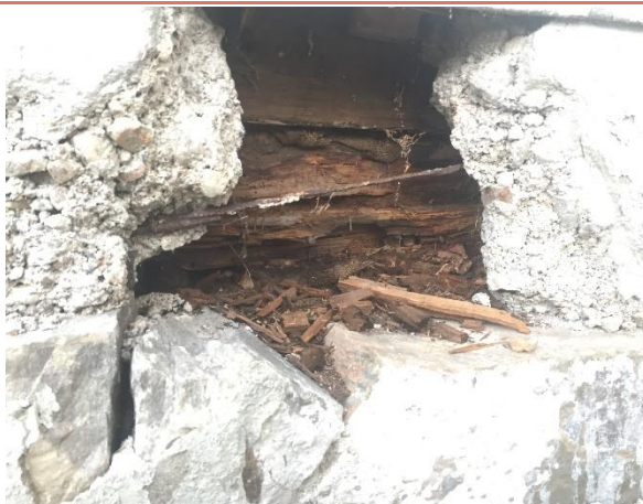
Råte i bunnstokk / laft har gitt synk i yttervegg og gulv.
