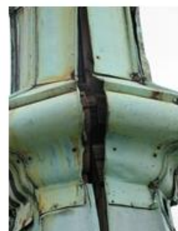
Svær sprekk både i tekningen og treverket bak.
