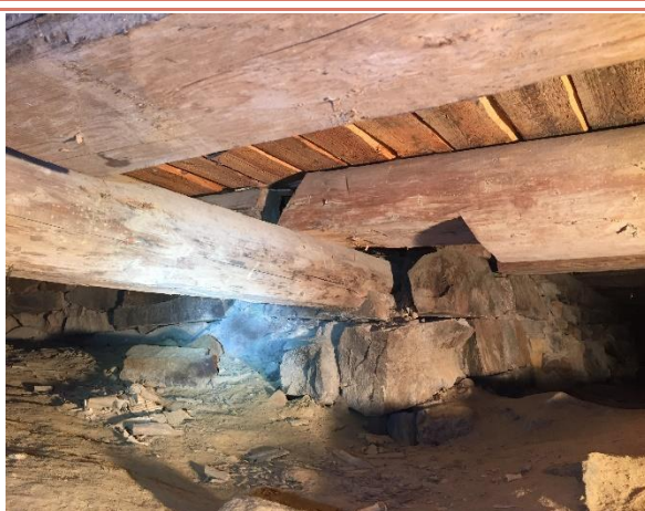
Eksempel på bjelkemøte med brudd i primærbjelke samt råte i både primær- og sekundærbjelke. Bemerk at trebjelkene kan se intakte ut på overflaten, mens det 2-3 cm innenfor denne kun er tremel og råterester.
