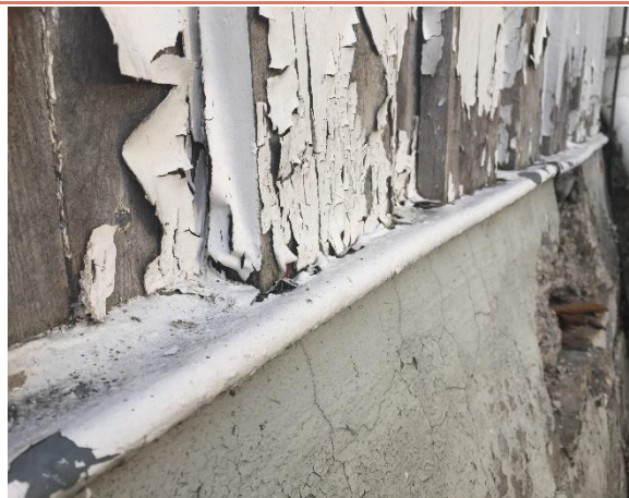
Sokkelbeslaget har rotet og fått fall innover som følge av råte i bunnstokken.
