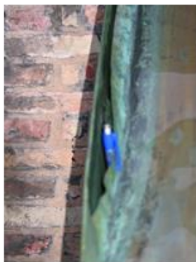
Svær glippe mellom beslag inn mot tårnvegg / gavlvegger.
