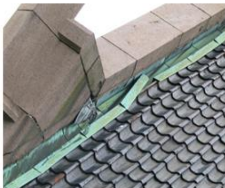
Beslaget langs gavlveggen har løsnet.
