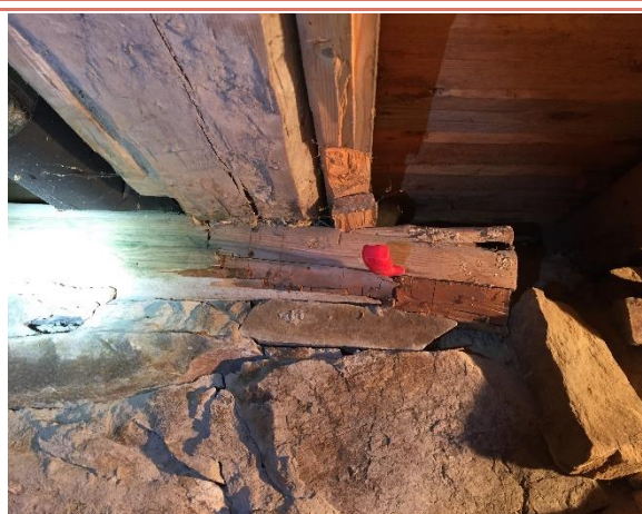
Oppleggsvill på steinfundament med både råte og brudd
